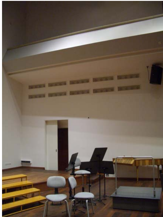
Nawiewniki WSA spec. – nawiew na scenę
